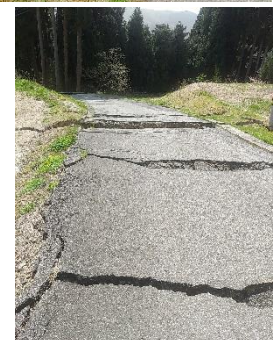
地震の爪痕が未だ残る道路
