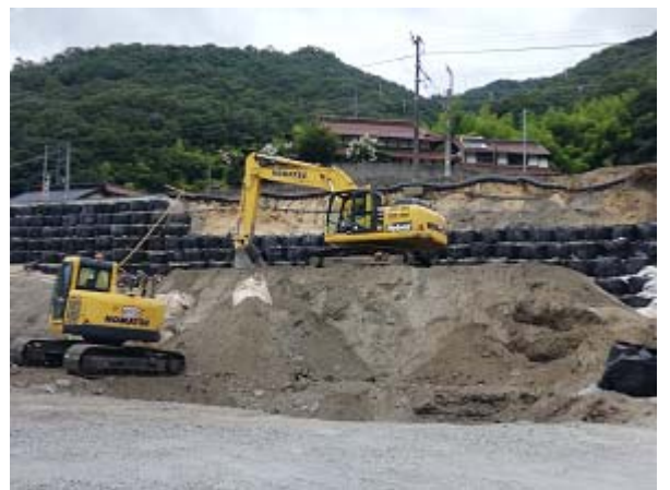
▲瀬野駅周辺では多数の被災箇所が確認された。
