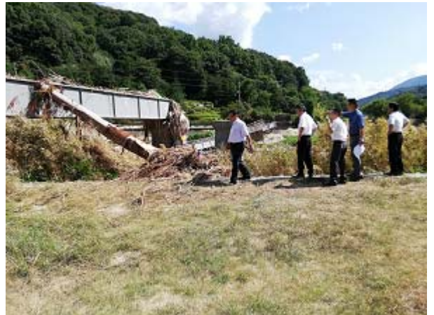
▲芸備線第1三篠川橋りょうは橋脚ごと倒壊した。
