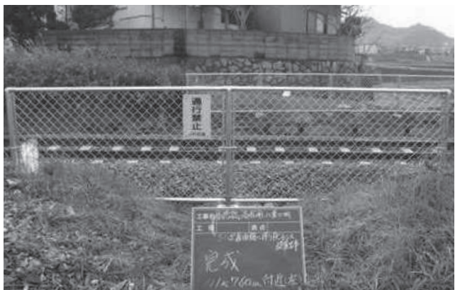
さく馬道の安全対策（2018年度の実績／予讃線14カ所、土讃線8カ所、徳島線1カ所、牟岐線4カ所の27カ所で設置
