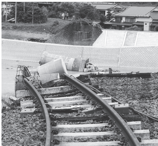
久大本線・花月川橋りょうは、橋脚が倒され線路が寸断された
