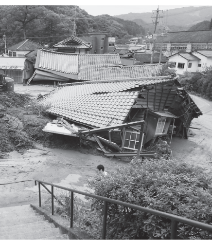
日田彦山線・大行司駅舎は山からの土砂により倒壊した
